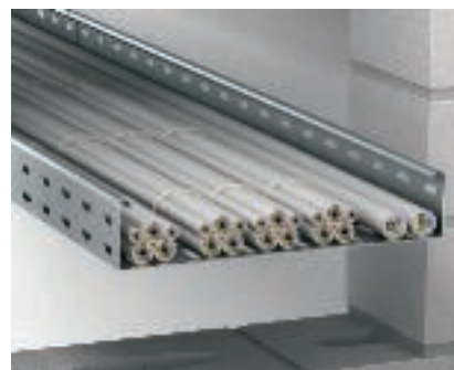
Фиксация внутри кабельного лотка Для предотвращения соскальзывания кабельные пучки в лотках можно зафиксировать с помощью кабельных стяжек.
