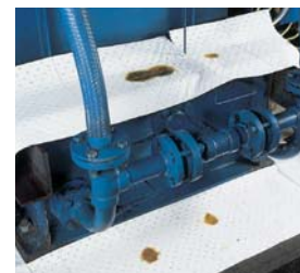
Вокруг машинного оборудования для сбора протечек
