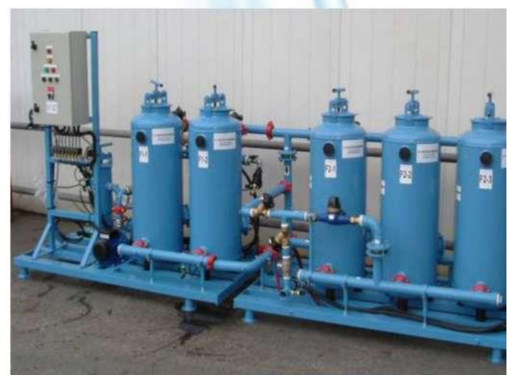
Установка смонтированная на Стеллаже
