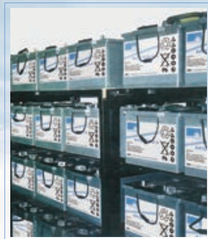
Рис. 14 Смонтированная батарея A400
