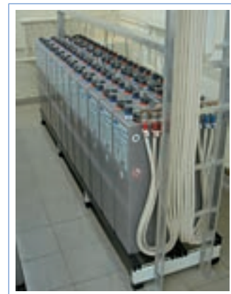
Рис. 18 Смонтированная батарея A600 OPzV
