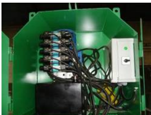
(Шкаф гидравлического управления)
