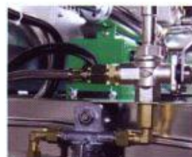
Кран подачи рабочего раствора
