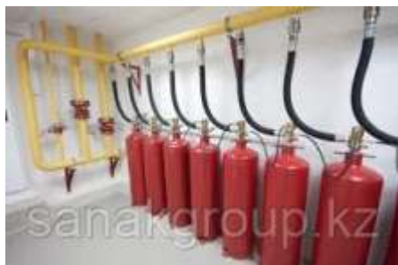
Обслуживание систем газового пожаротушения
