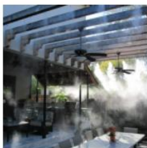
Охлаждение воздуха и кондиционирование
