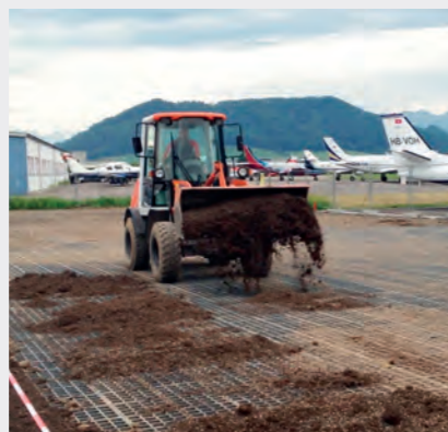
Засыпка субстрата (смесь почвы и песка) в качестве заполнителя ячеек элементов; посев травы и окончательная отделка
