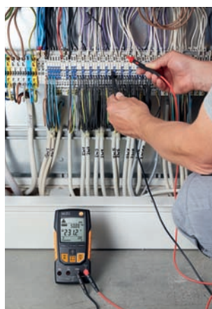
Проверка напряжения в распределительном щитке
