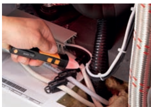
Первый тест подачи напряжения на компрессоре
