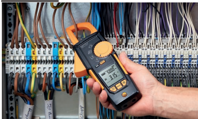
Измерение силы тока в распределительном щитке
