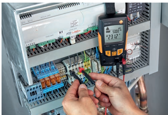
Проверка напряжения в щитке автоматики теплового насоса
