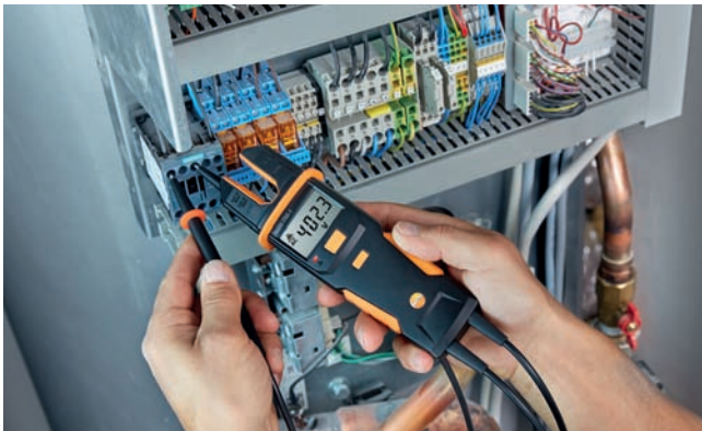
Проверка напряжения на тепловом насосе с testo 755
