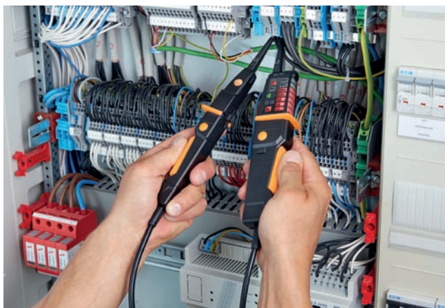
Измерение напряжения в распределительном щитке
