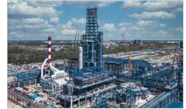
АО «ГАЗПРОМНЕФТЬ-ОНПЗ» г. Омск – Мультизональные системы Electrolux
