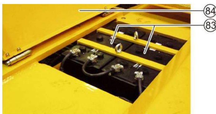
Ilustración 4-16: Baterías (referencia PFL 30)
