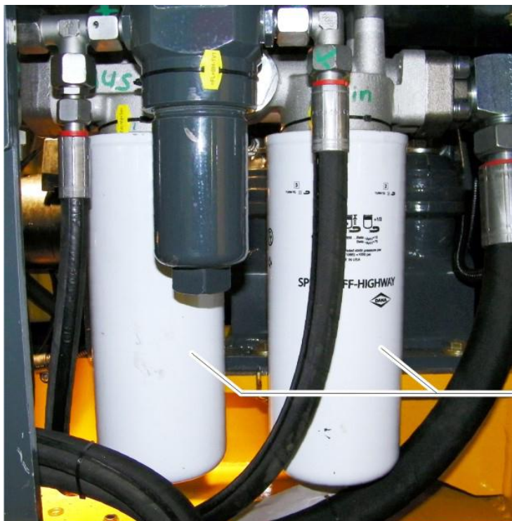
Ilustración 8-7 Filtros de aceite del convertidor
