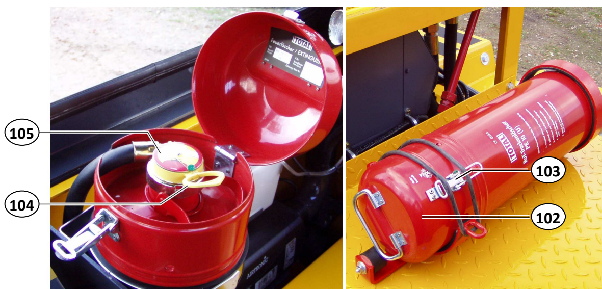
Ilustración 4-30: Extintor manual contra incendios ABC
