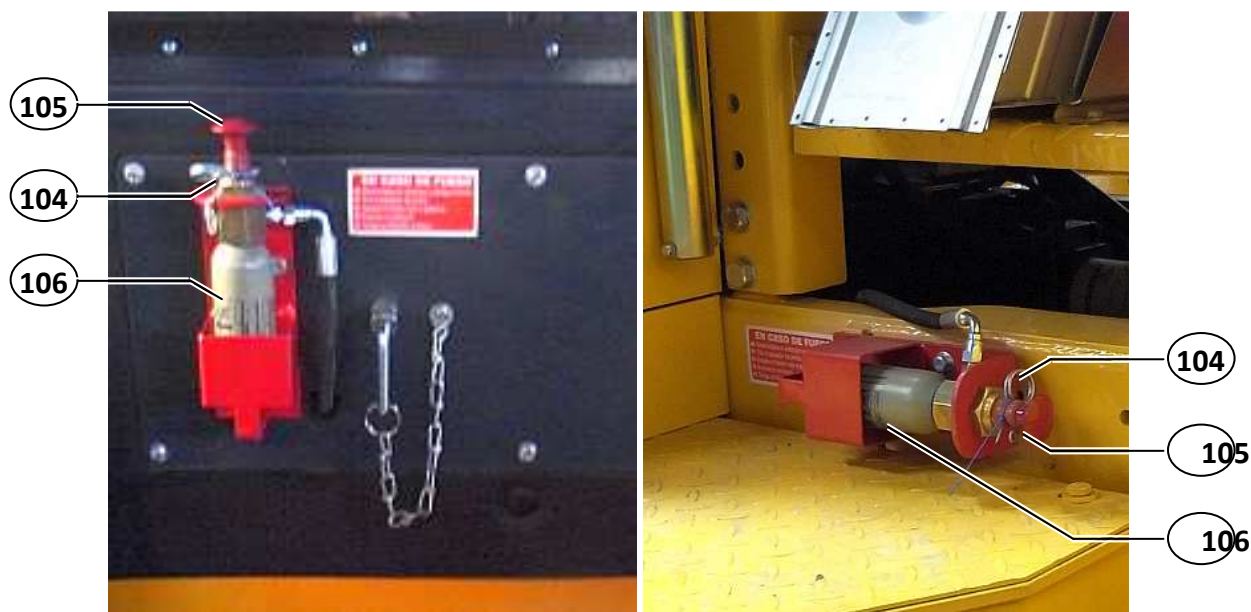
Ilustración 4-31: Iniciadores sistema contra incendios
