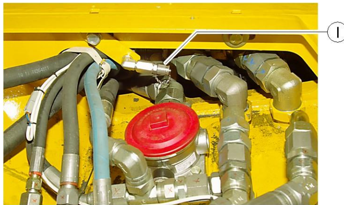
Fig. 7-13: El punto de medición (I) se encuentra por encima del filtro de retorno
