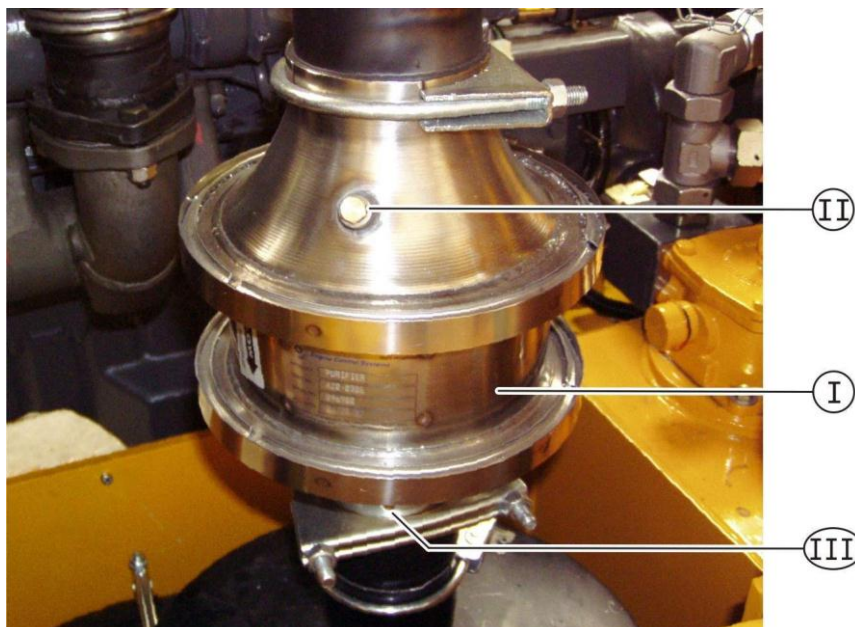
Fig. 7-11: Orificios para la medición de gases de escape en el catalizador (Imagen de muestra)
