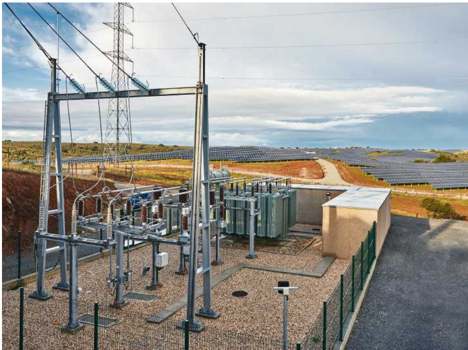
Точка подключения фотоэлектрической системы к сети в Муре (Португалия) с системой управления выдаче мощности от Phoenix Contact
