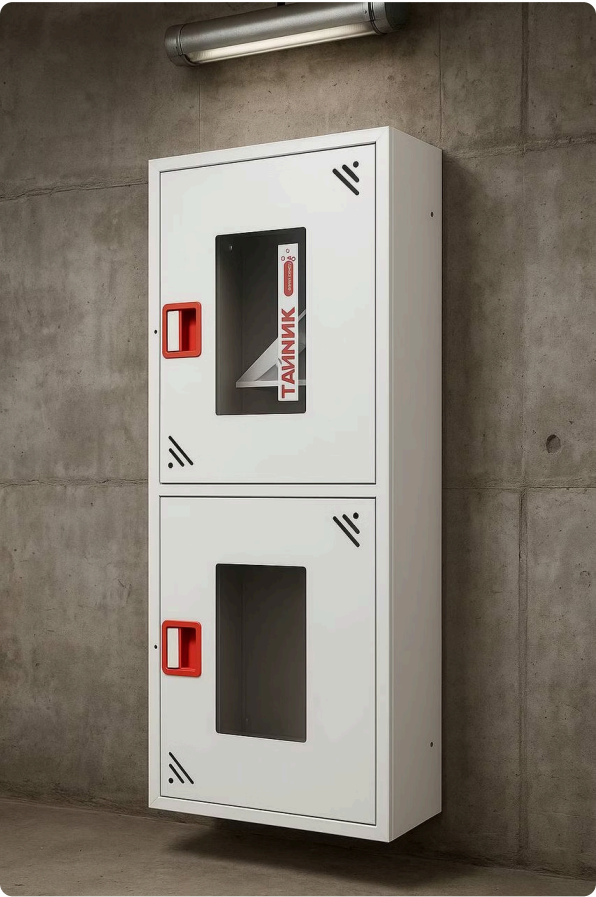
Шкафы пожарные ТАЙНИК KZ
