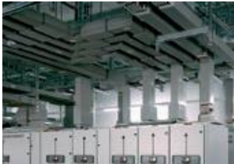
Трансформаторы - панели и их общие, основные линии питания
