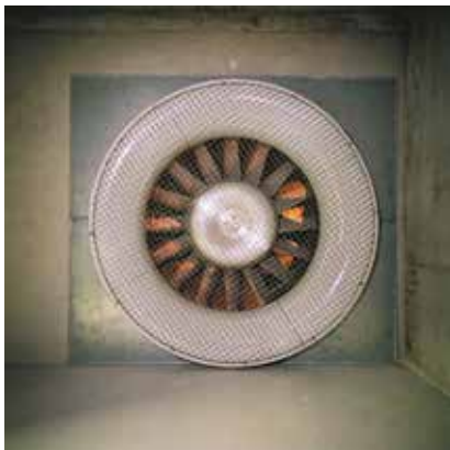
Применение в вентиляционных установках
